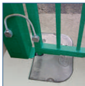
Moteur encastré au sol
